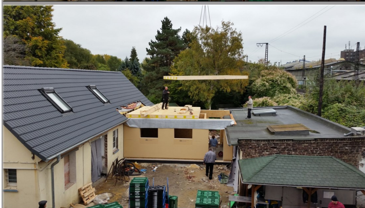
22. Oktober 2015: Der Zwischentrakt des neuen Küchen- und Kantinenbereichs wird per Kran errichtet
